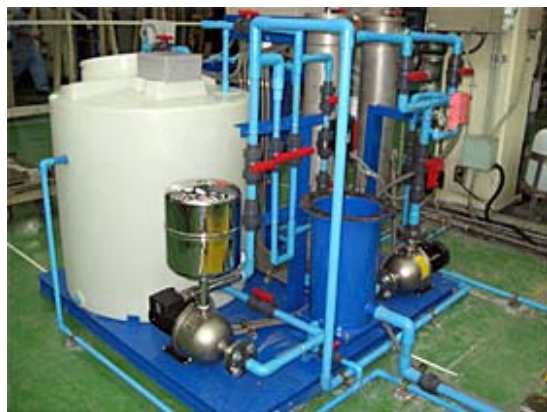
排水の循環処理装置
