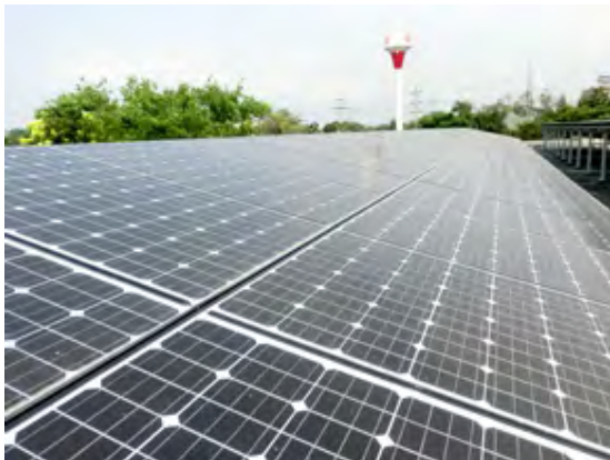
Siam Compressor Industry Co., Ltd.に導入された太陽光発電システム
