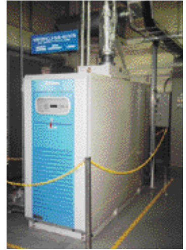
オスラム・メルコ(株)が導入したマイクロガスタービン・コージェネレーションシステム
