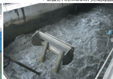
▼新設されたMGCの污水处理施設。
