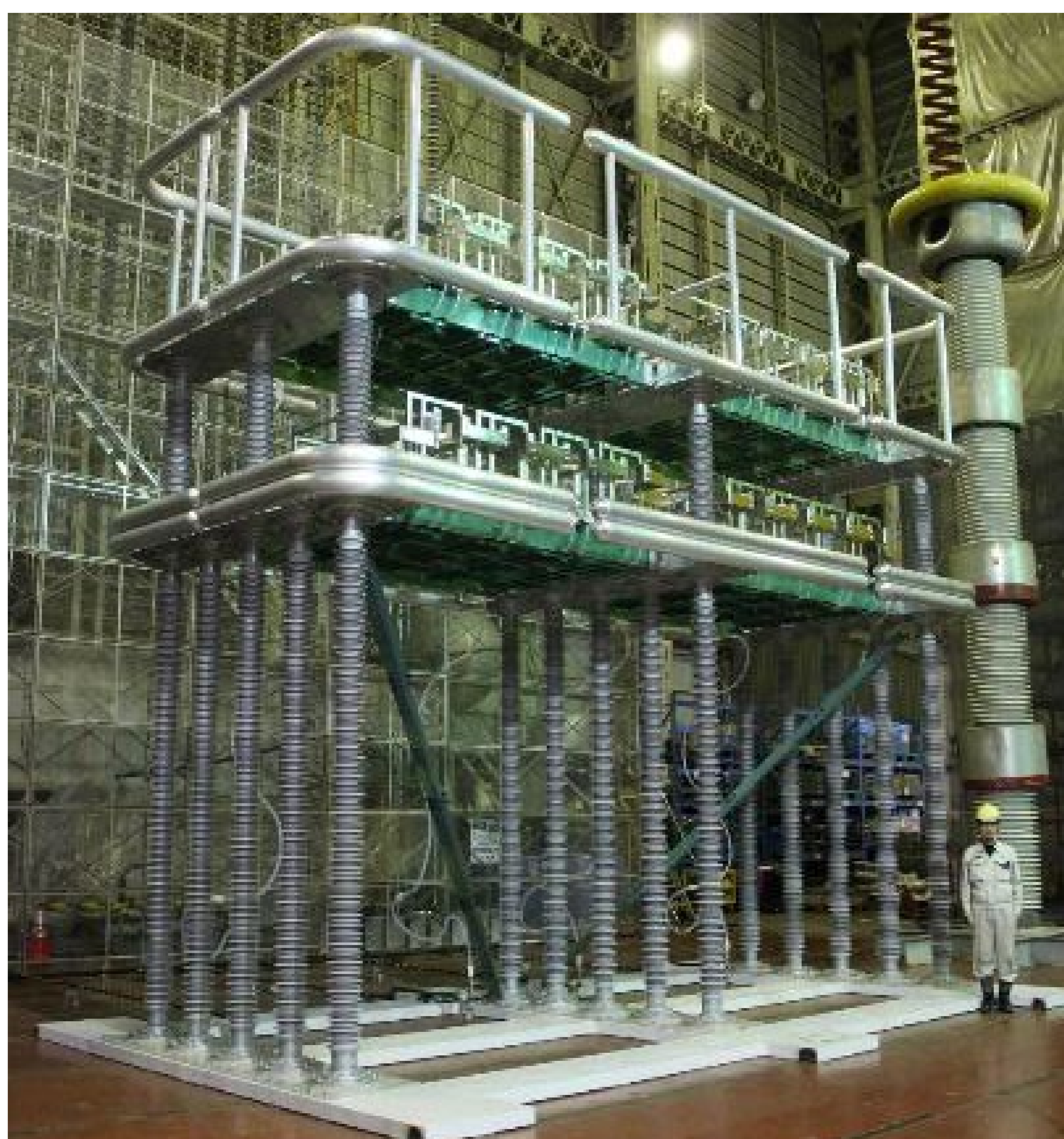
400 kV バルブタワー
