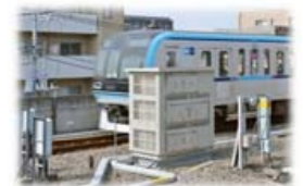
駅舎補助電源装置
