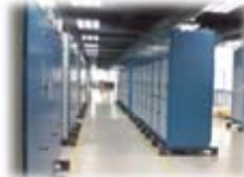
中国原子力発電所向け デジタル計装制御システム
