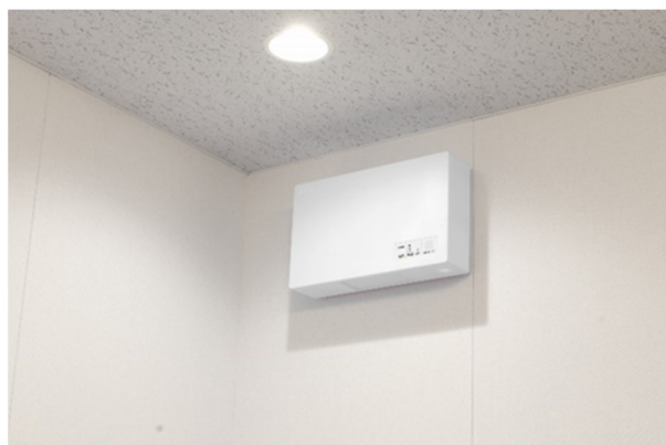
図2 「ヘルスエアー®機能」搭載循環ファン「大風量タイプ」の設置イメージ
