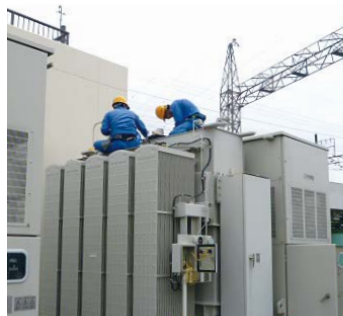
変電／受配電設備
