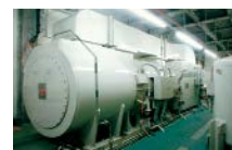
フライホイール式電車線電力貯蔵装置
